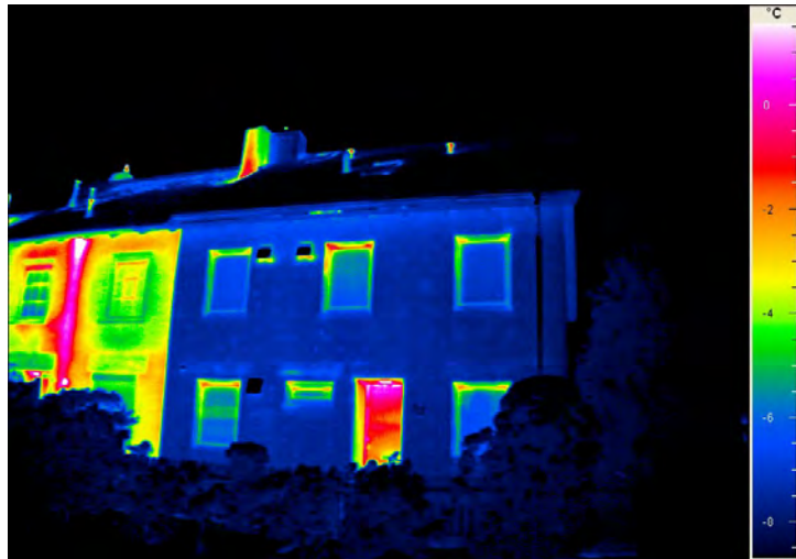
Abb. 7: Thermographiebild eines Green Buildings (Quelle: Bethe)
